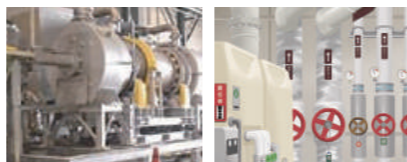
ガス炉 ボイラー
