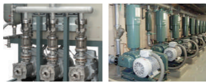
給水ポンプ 排水ポンプ
